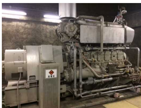
<自家発電機／新潟港>
