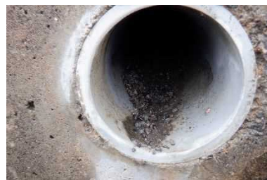
水抜き穴の内部に土砂が堆積
