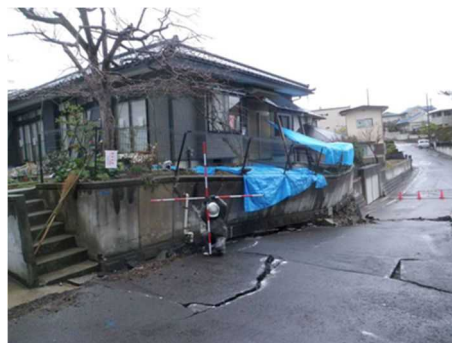
b) 宅地擁壁の崩壊
