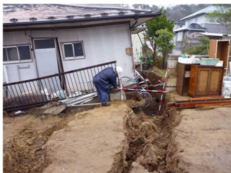
a) 宅地地盤のクラック
