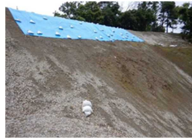
(b) 盛土のり面勾配が急で肌落ちがあり、擁壁工や構造物によるのり面保護工がない
