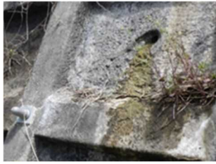
(c) 水抜き穴からの湧水
