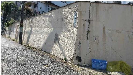
③擁壁単体の劣化
