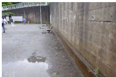
擁壁前面に土砂が堆積
