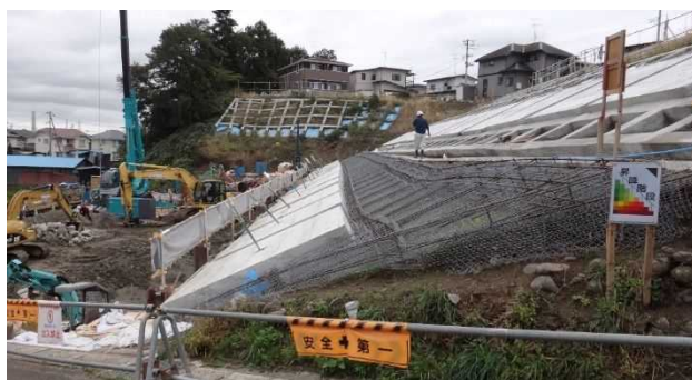
図参 5.1.8 グラウンドアンカー工法（現場打ちのり枠工+グラウンドアンカー工）の施工状況（NK地区の例）
