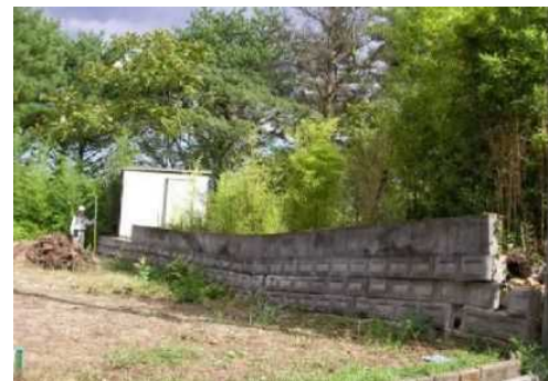
b) 宅地擁壁及び基礎地盤の被害
