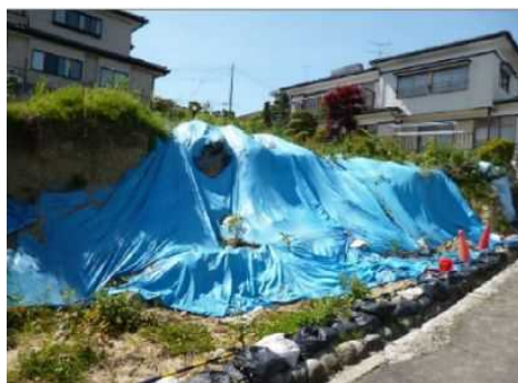
図参 6.5.4 ひな壇部分の変形被害が発生した地区の被害写真
