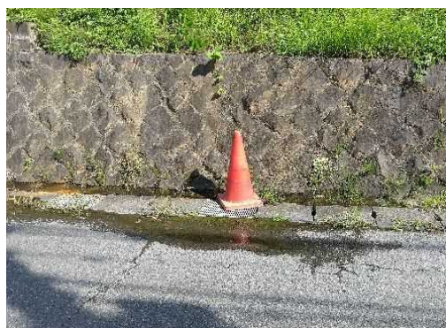
擁壁下部からの水のしみ出し
