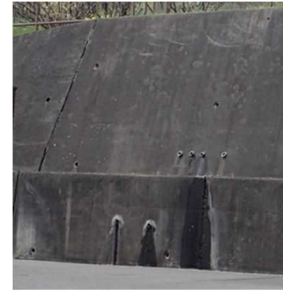
(b) 擁壁水抜き穴からの出水 (暗色部) や痕跡 (白色部)
