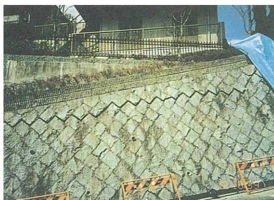
図 9.1 擁壁の沈下例 2
