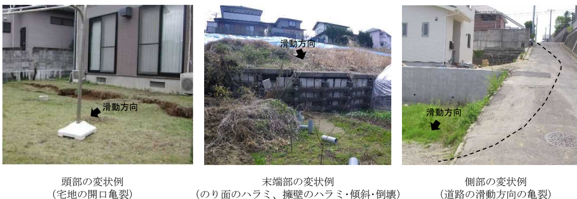
図 3.2.2 滑動崩落を示唆する変状の例
