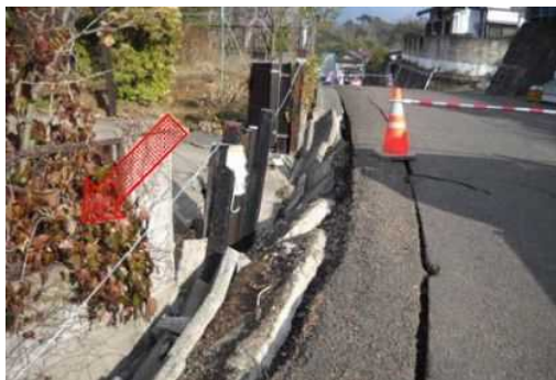
a) 盛土頭部のクラック
