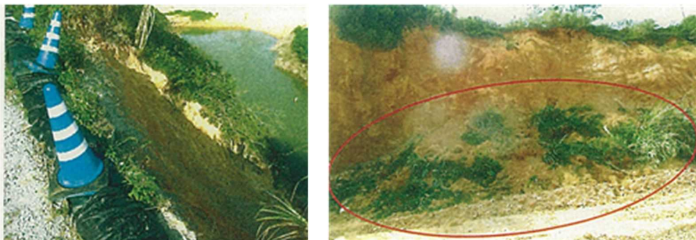
図参 1.1.3 切土の表層崩壊の様子
