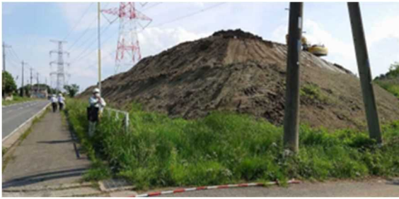
(a) 盛土のり面勾配が急で、構造物によるのり面保護工や防護工がない
