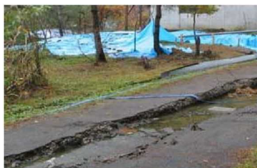
道路の沈下・段差
