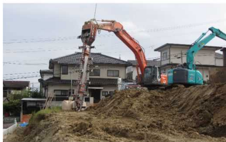
図参 5.1.2 固結工法（中層混合処理工）の施工機械（N地区の例）
