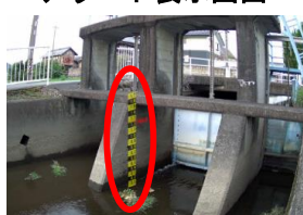
AIによる水位計測 バーチャル水位標表示
