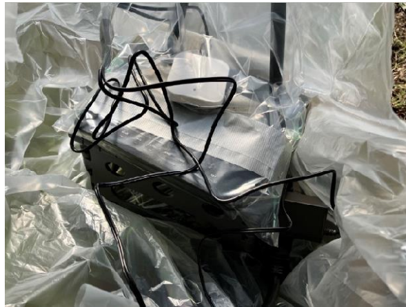
図 43 機器の設置の様子
