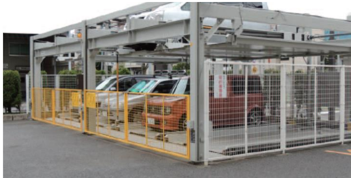
写真 外部者の侵入を防ぐ前面ゲートと柵の設置例
