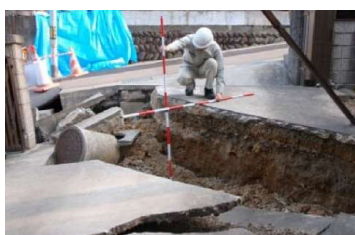
写真-2.2.2 宅地地盤の沈下による段差
