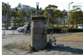
写真-2.2.5 マンホールの浮き上がり
