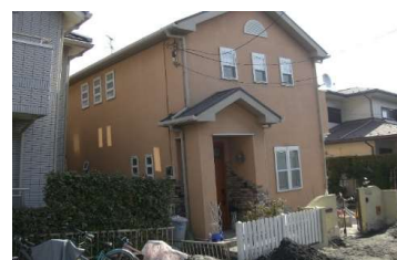
写真-2.2.3 戸建て住宅の沈下・傾斜
