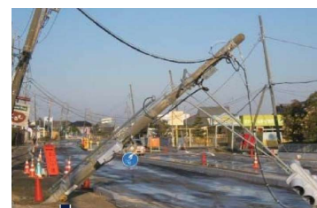
写真-2.2.6 電柱の傾斜
