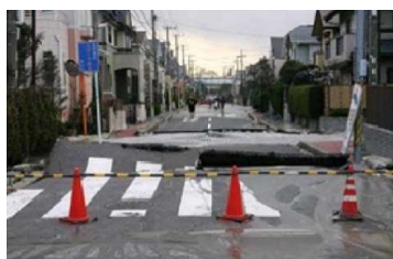
写真-2.2.4 道路面の変形
