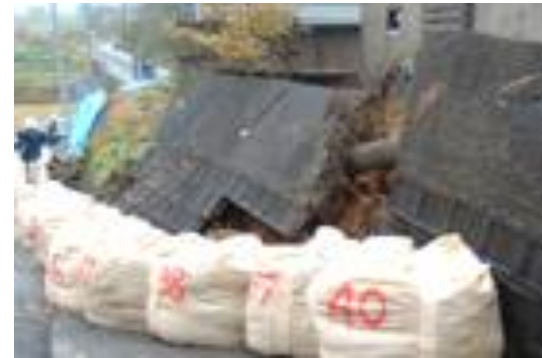
図-2 増し積み擁壁の崩壊
