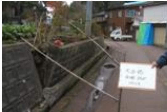
図-1 ブロック擁壁の転倒
