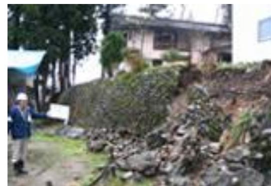
図-4 水抜き穴のない石積み擁壁の崩壊
