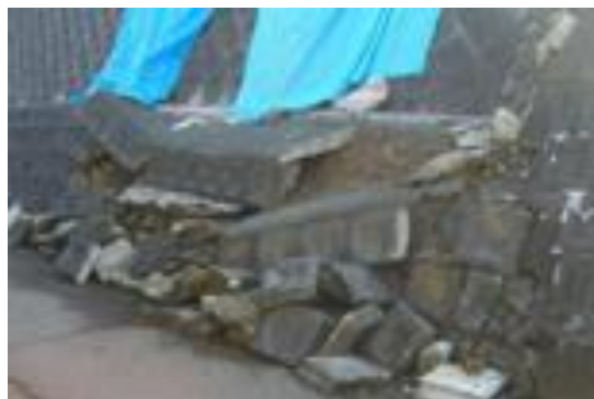
図-3 下段部が崩壊した多段擁壁
