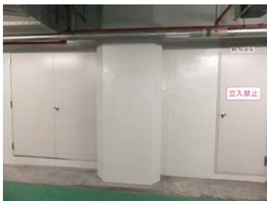
写真2.2 耐震補強工事の実施例 RC壁補強+耐震スリットの施工完了 状況（エスカ）
