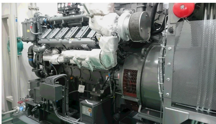
写真2.20 新たに設置された非常用発電設備
