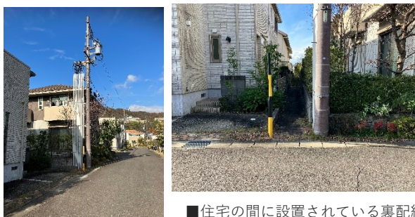
■住宅の間に設置されている裏配線
