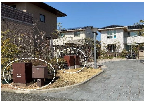
■道路緑地に設置された地上機器
