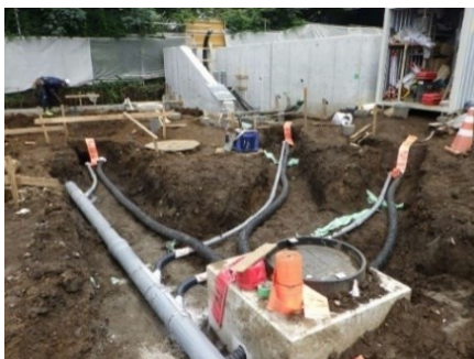
■ 樹と管路埋設工法の電線管
