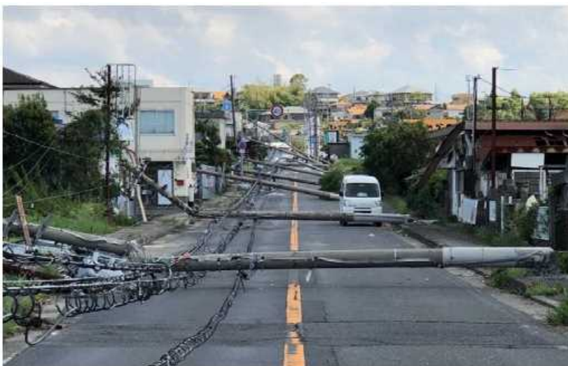
2018年台風第21号による電柱倒壊
