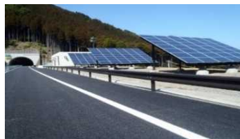
道路における太陽光発電施設活用
