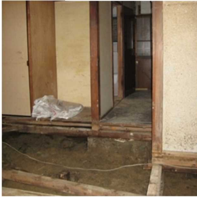
図 1-3 床下に土砂が堆積している例 (資料/平成 26 年広島土砂災害 (広島市八木地区の被災者へのヒアリング結果))
