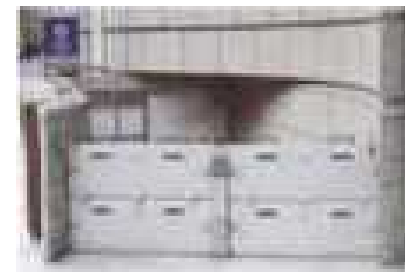
浸水対策の例： 止水板（脱着式）の設置 1
