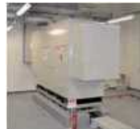
非常用発電設備のイメージ
