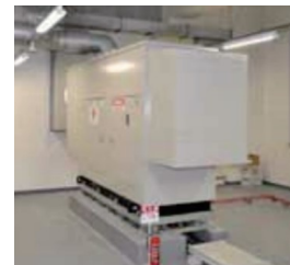
非常用発電設備のイメージ
