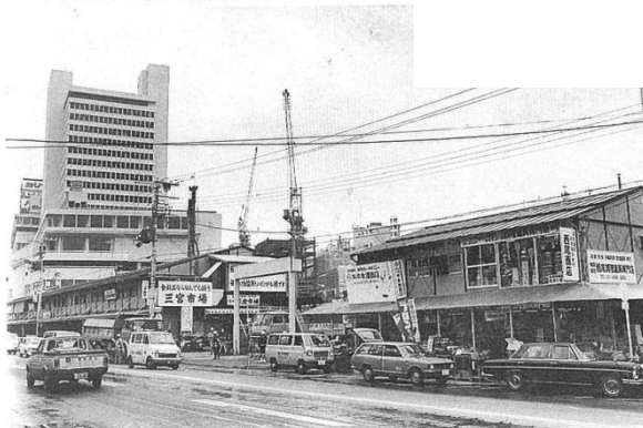
▽センタープラザ西館の建設現場を中央幹線(山側)より見る。仮設店舗で営業した。(昭和51年7月25日撮影)
