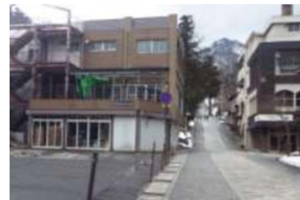
廃屋となっていた元宿泊施設
