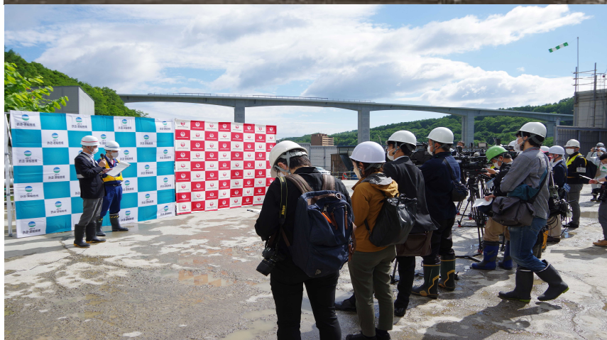
上段: 見て・知って・学ぼう 北海道新幹線見学ツアー(令和4年1月) 下段: 後志トンネル工事現場報道公開(令和4年6月)
