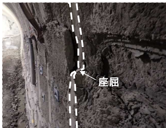
支保工の座屈状況
