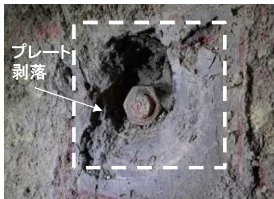
ロックボルトの変状状況
