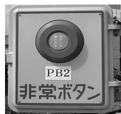
非常押しボタン
