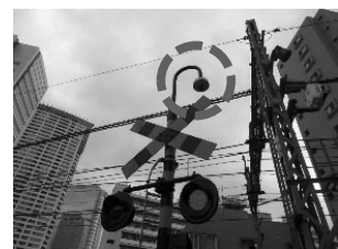
踏切監視用カメラ
