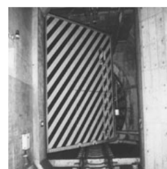
防水扉(トンネル内)
