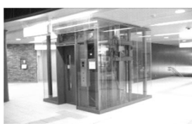
エレベーター
