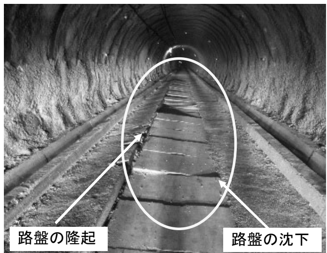
トンネル（先進導坑）の変状
