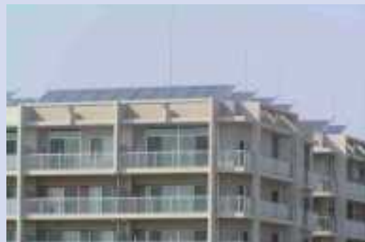
環境モデル街区の太陽光温熱パネル
