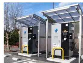
充電施設 蓄電池
