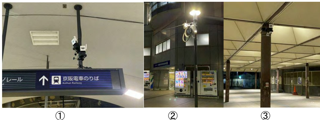
図 28 IoT カメラの設置箇所と状況
