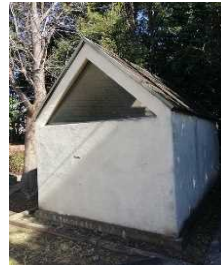
窓がひび割れた屋外トイレ
