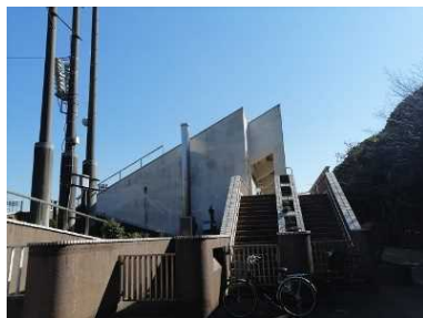
老朽化が目立つ施設外壁
