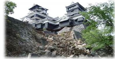
被災状況 (熊本城)
