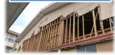
被災状況 (体育館)
