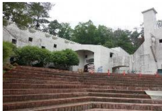
建物外観。外壁の汚れが目立つ
