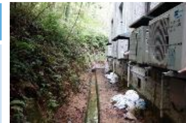
宿泊棟への土砂被害の痕跡
