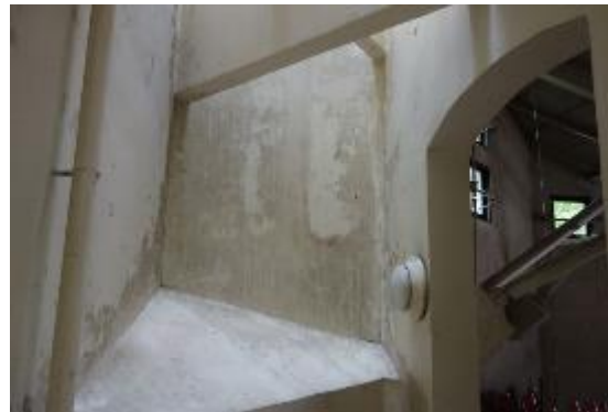
劣化が目立つ内壁
