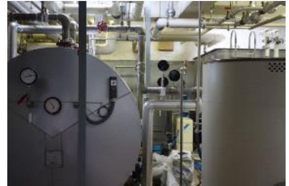
ボイラー室。以前に比べると部屋が温まりにくいことあり
