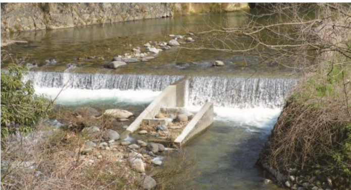
① 過去に設置された魚道が破損
