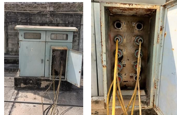
老朽化が顕著な電源設備
