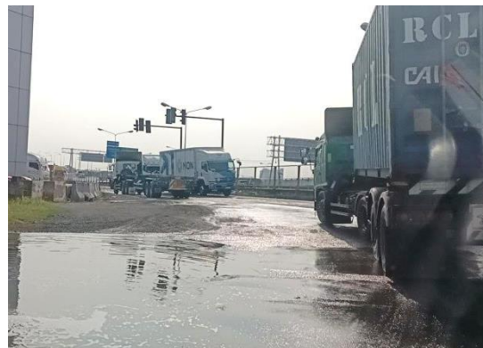
ICD周辺道路 (凸凹による道路上の大きな水溜まり)
