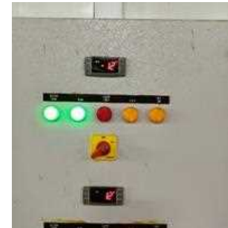
冷凍倉庫温度設定
