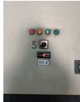
冷凍倉庫温度設定
