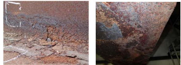
写真-5.1 層状剥離さび
