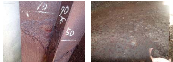
写真-5.2 うろこ状さび・こぶ状さび
