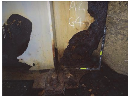
写真-2.4 桁端部の損傷事例
