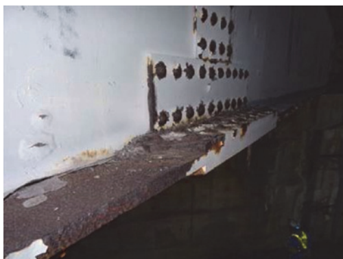
写真-2.5 下フランジと継手部の損傷事例
