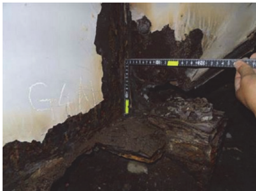
写真-2.3 支点部の損傷事例
