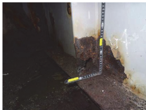
写真-2.6 下フランジと補剛材の損傷事例
