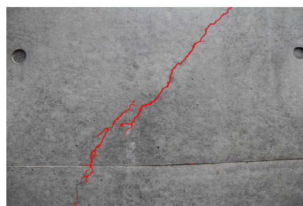
図 2.5 ひび割れ検出結果
