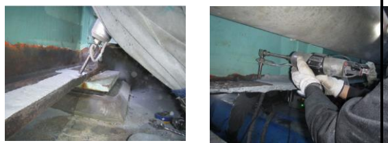
写真7 (a) 下フランジ上面（通常） (b) 排水管干渉
