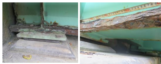
写真5 実証試験対象の桁端部の腐食状況
