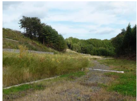
写真2-1 集水地形に建設された盛土（越の原IC付近，復旧後）
