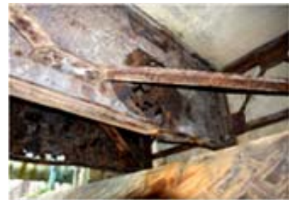
<河川護岸直上の腐食状況>
