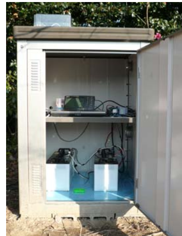
写真-5 PC ラック (Network M3)
