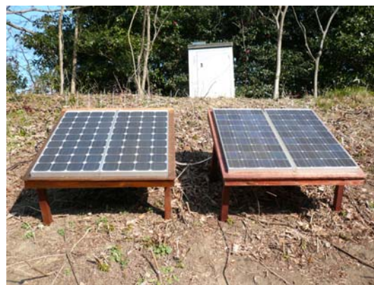
写真-9 太陽光発電装置
