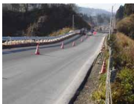
写真-5.2.2 滑らかな縦断方向の沈下例 (2004新潟県中越地震、国道117号細島)
