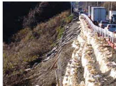
写真-5.1.2 法面、路肩の小規模なすべり破壊 (同上、細島)
