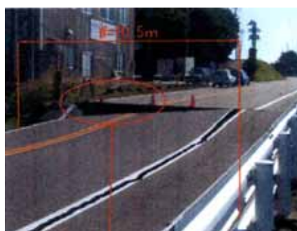
写真-5.2.1 段差規模と縦断線形の円滑性の差異の事例 (2004新潟県中越地震、国道17号石田南平)
