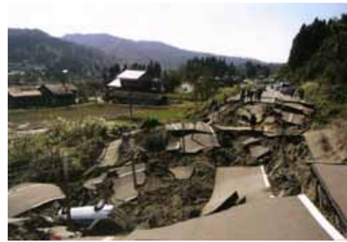
写真-5.1.1 2車線に至る大規模なすべり破壊 (2004新潟県中越地震、国道117号、細島)
