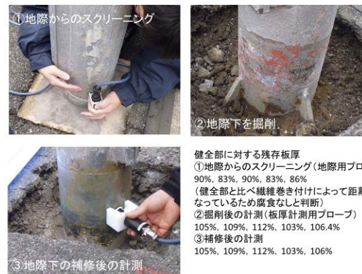
図2 標識柱の地際腐食計測
