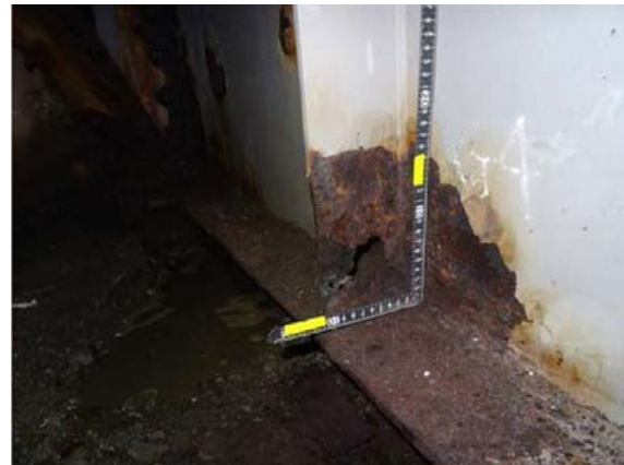
写真-6 下フランジと補剛材の損傷事例
