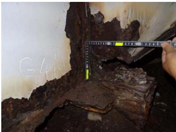
写真-3 支点部の損傷事例
