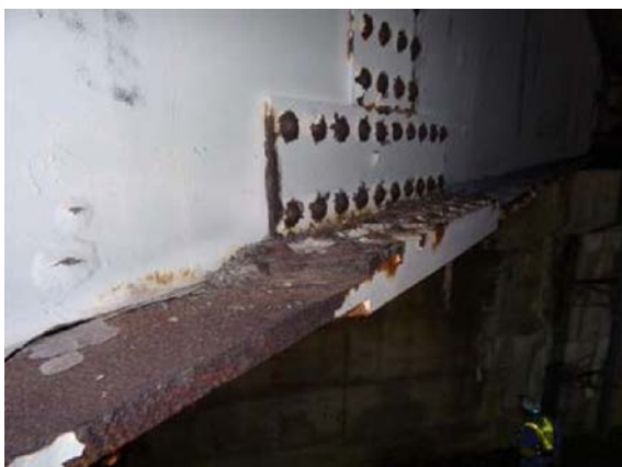
写真-5 下フランジと継手部の損傷事例
