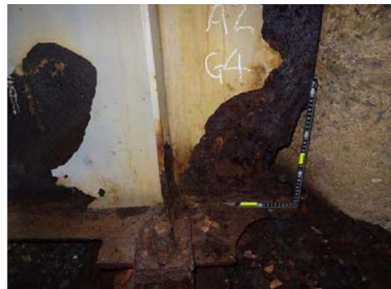
写真-4 桁端部の損傷事例
