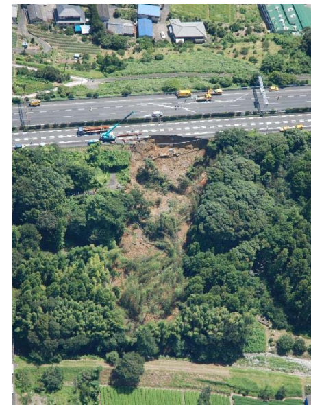
2009年駿河湾(静岡)の地震での道路盛土崩壊 (国際航業・パスコ, 2009, 8)
