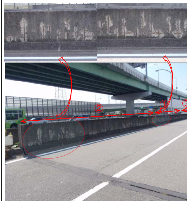
壁高欄損傷状況
