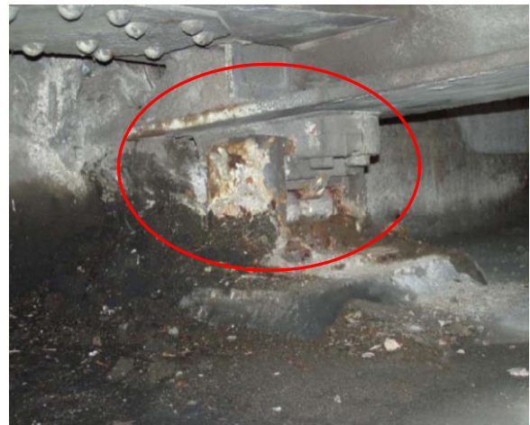
支承が腐食するとともに土砂詰まりしている
