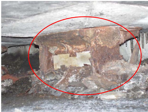
著しく腐食し支承としての機能を失っている
