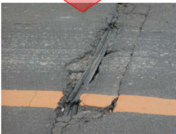
伸縮装置が損傷し、舗装にひびわれが生じている
