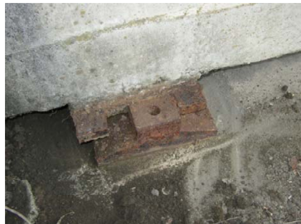
腐食が進行している支承
