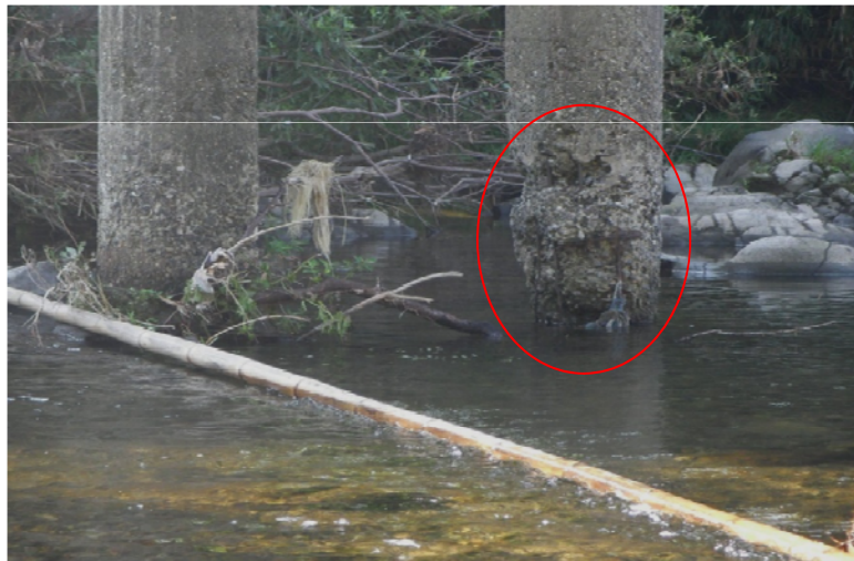
コンクリートの剥離・鉄筋露出
