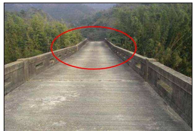
橋脚の沈下に伴って発生した路面の変状
