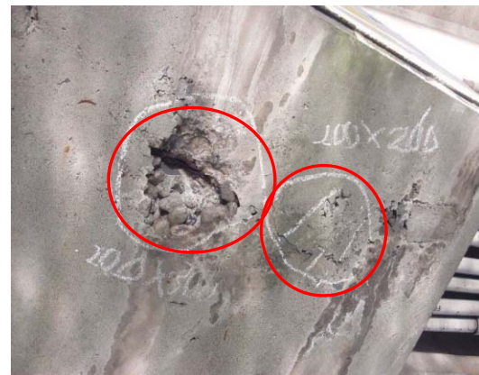
鉄筋露出とコンクリートのうき
