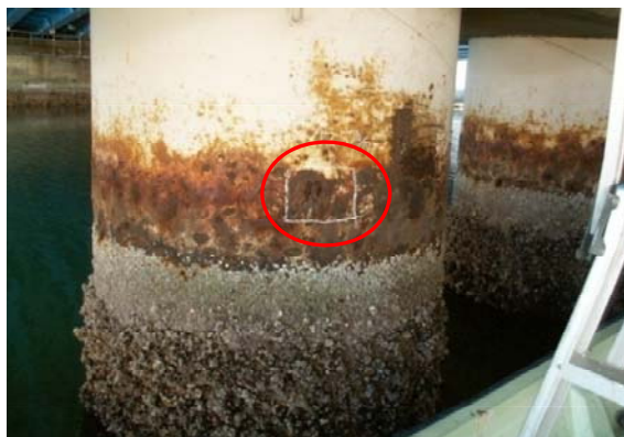
断面欠損が生じている部分もある
