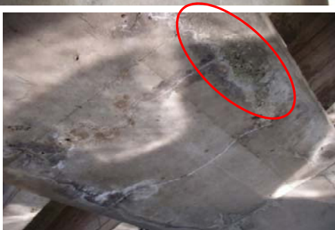
遊離石灰を伴うひびわれ
