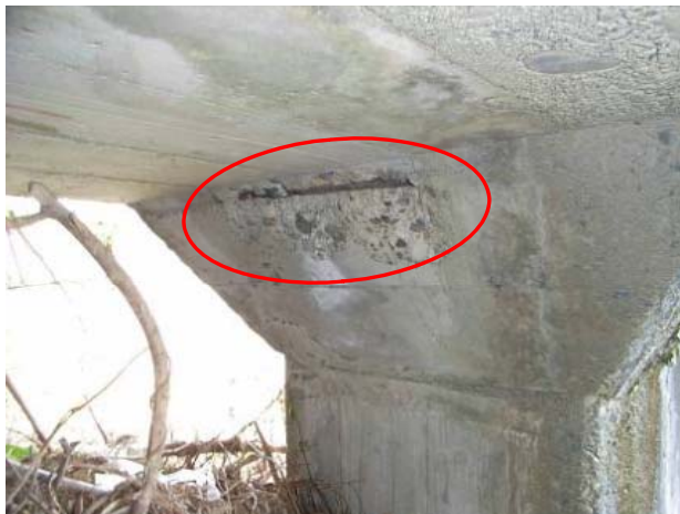
コンクリートの剥離・鉄筋露出
