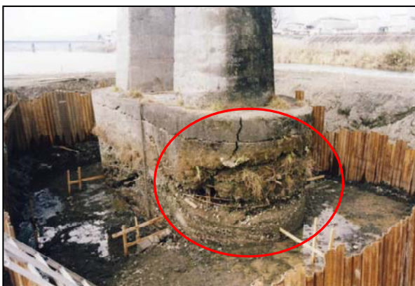
ケーソン基礎のコンクリート劣化状況
