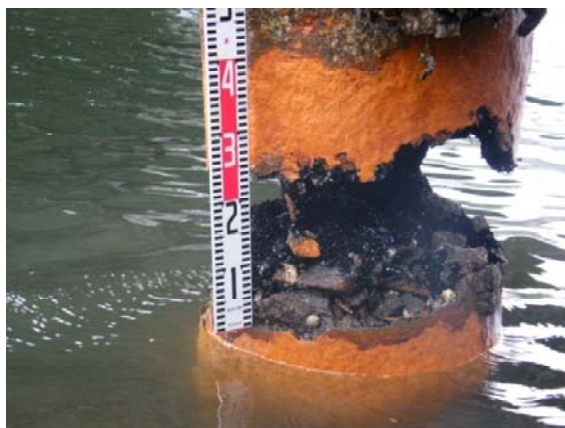
右の写真の損傷部に付着していた貝殻や腐食部分を叩き落とした後の状況
