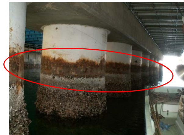
橋脚の全ての鋼管杭の腐食が進行している
