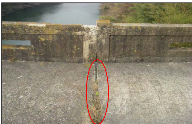
橋脚の沈下による変状
