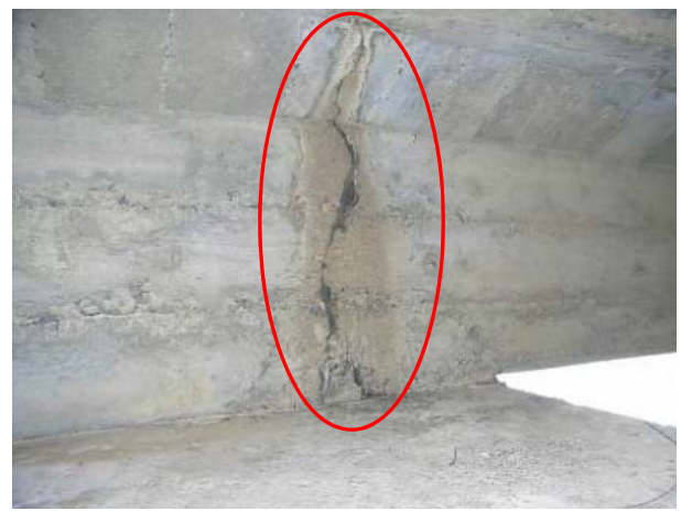
伸縮継手からの漏水状況
