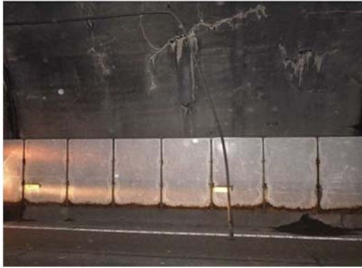
落下したケーブル
