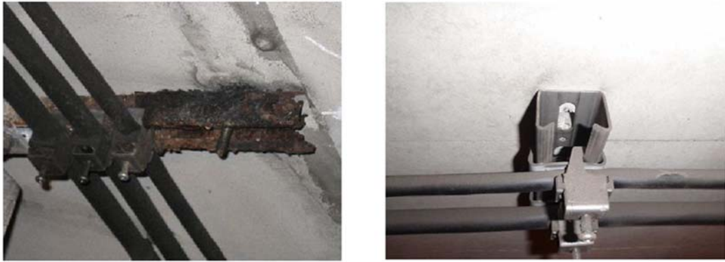
写真-1 固定金具の腐食とアンカーボルトの脱落の例
