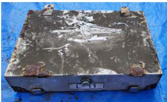
照明灯具の背面（取付脚の腐食）
