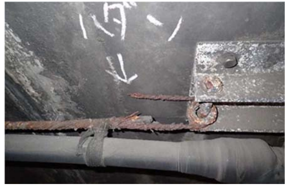
破断した取付部材
