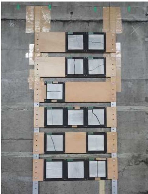
ひび割れパネル状況(遠景)
