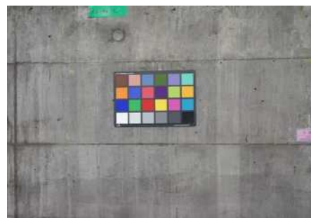
カラーチャート状況
