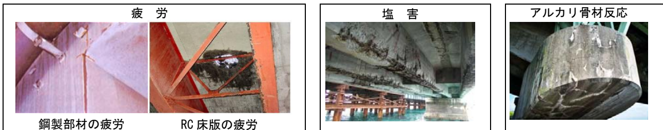
図 11-1 三大損傷の写真
