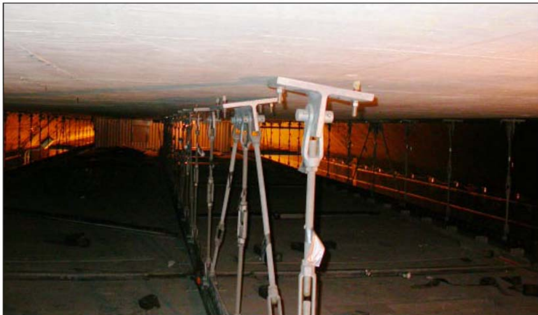
州際道路 90 号トンネル（ボストン）におけるアンカーボルトの変状
