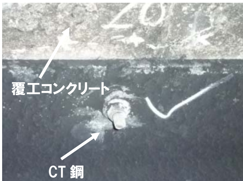
笹子トンネル（上り）における天頂部接着系アンカーボルトの固定状況
