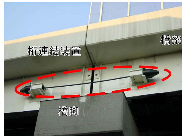
橋桁をケーブルで連結し、落下防止
