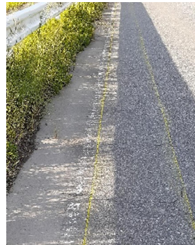
区画線の摩耗
