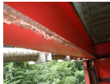
・B判定(腐食)
