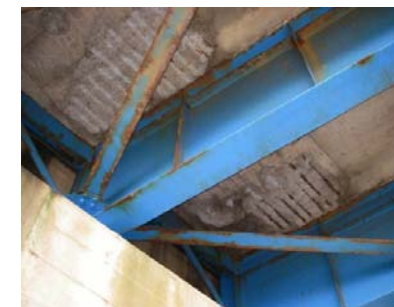
・C判定(剥離・鉄筋露出)
