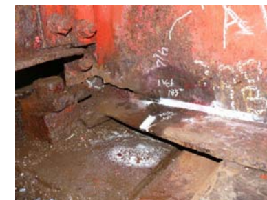
・E判定(腐食・亀裂)
