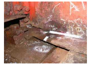
・E判定(腐食・亀裂)
