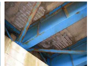
・C判定(剥離・鉄筋露出)
